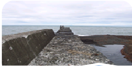
外的要因(中性化・塩害・アルカリ骨材反 応・凍結融解等)による劣化の進行
