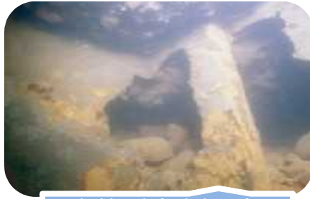
鋼材の腐食・矢板孔食 による内部土砂の流出
