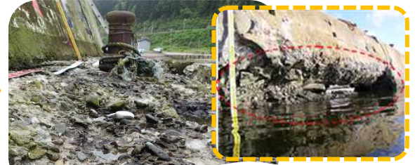
コンクリートの剥離・剥落進行による 構造物としての耐力(安定性)の低下
