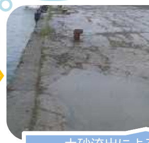
土砂流出による エプロンの沈下・陥没
