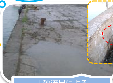
土砂流出による エプロンの沈下・陥没
