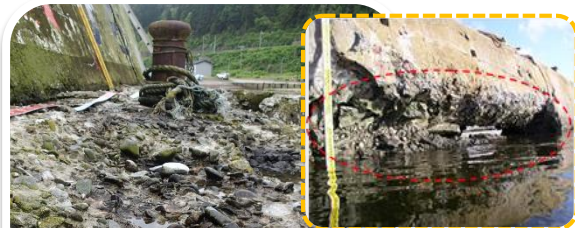
コンクリートの剥離・剥落進行による 構造物としての耐力(安定性)の低下
